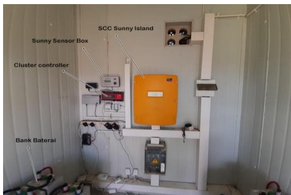
Gambar 6. Ruang kontroler dan baterai pada PLTS off-grid Kampung Abar
